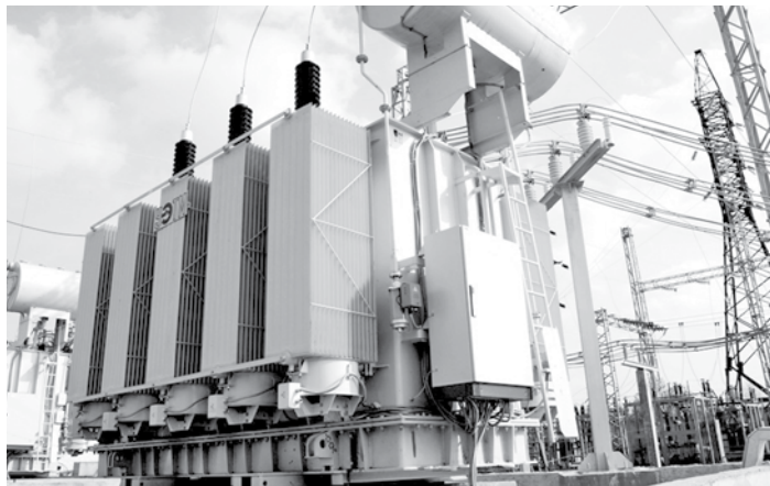
Подстанция 110/35/10 кВ «Горшечное»
