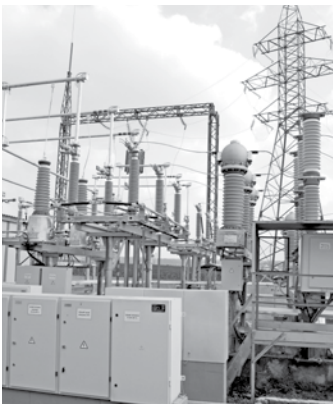
Подстанция 110/10 кВ «Бекетово»
