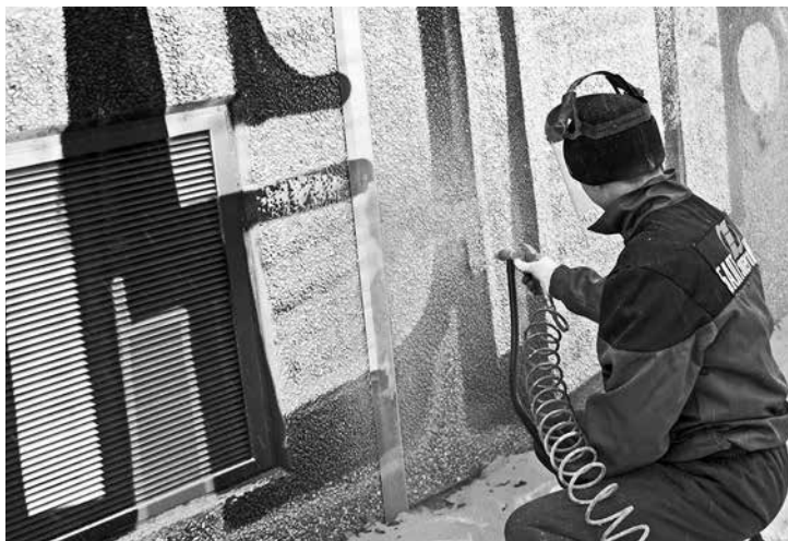
Стоимость очистки фасадов БКТП с современным покрытием почти в 10 раз меньше стоимости перекраски испорченных поверхностей с обычным покрытием
