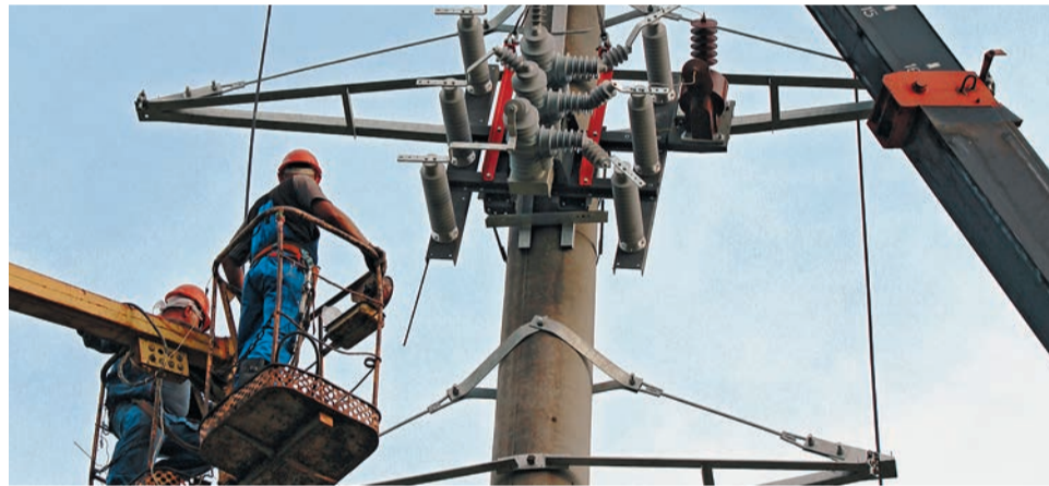
Вакуумный реклоузер способен автоматически выделять и отключать поврежденные участки сети, восстанавливая питание на неповрежденных участках
