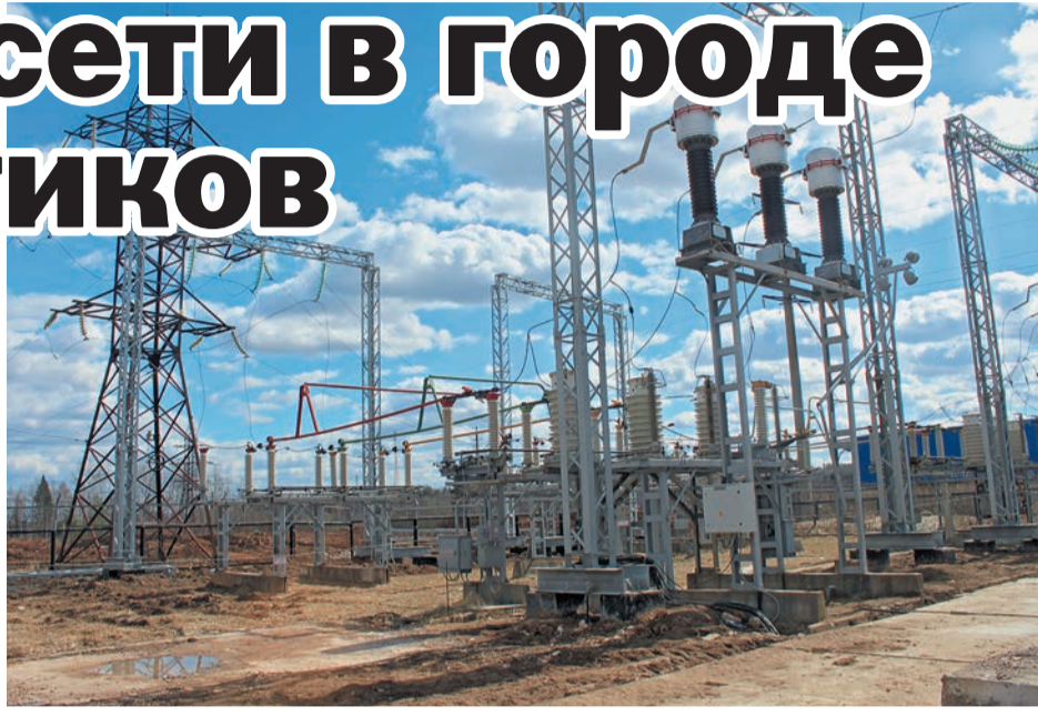
Подстанция «КПД», от которой будет запитан новый завод, прошла комплексную реконструкцию и обладает необходимым резервом мощности
